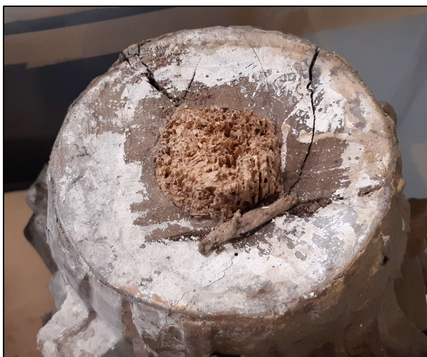
Ill. 46 : Détail d'une cheville qui assure l'assemblage entre le chapiteau et la colonne. L'attaque des insectes xylophages semble avoir eu raison de la cohésion du bois. Deux fentes de dessiccation affectent également la cohésion de l'ensemble.
