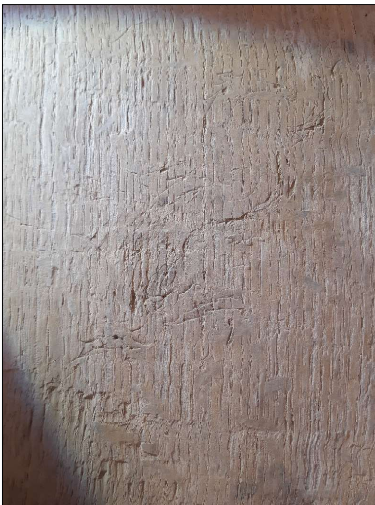
Ill. 26 : Détail des traces d'outils en lumière rasante.
