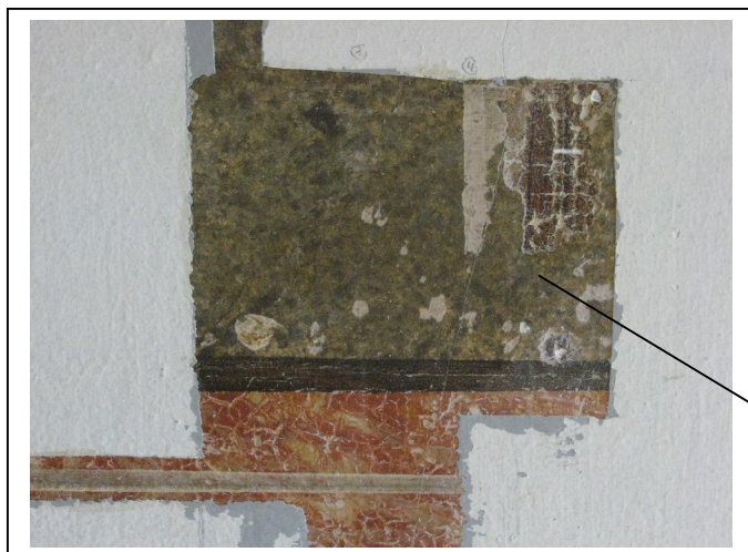
Détail de la succession des strates au niveau de la partie inférieure du mur Est. Ci-dessous : détail des altérations du premier faux bois posé sur l'enduit.
